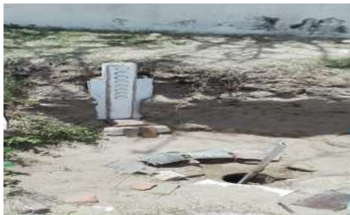
FIGURA 5. POZO DE MONITOREO Y SISTEMA DE DETERMINACION DE TEMPERATURA Y HUMEDAD.
